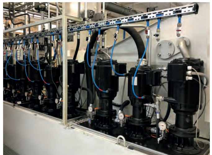
Geräuschreduzierung der Anlage durch den Umbau auf wassergekühlte Motoren um 8 dB(A), bei gleichzeitiger Erweiterung um drei Pumpen
