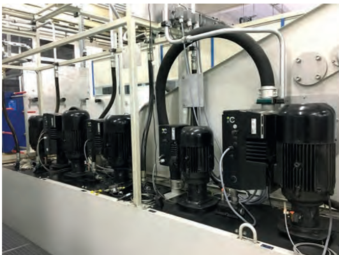
Klassisch, mit luftgekühlten Motoren ausgestattete KSS-Pumpen auf einer Filteranlage
