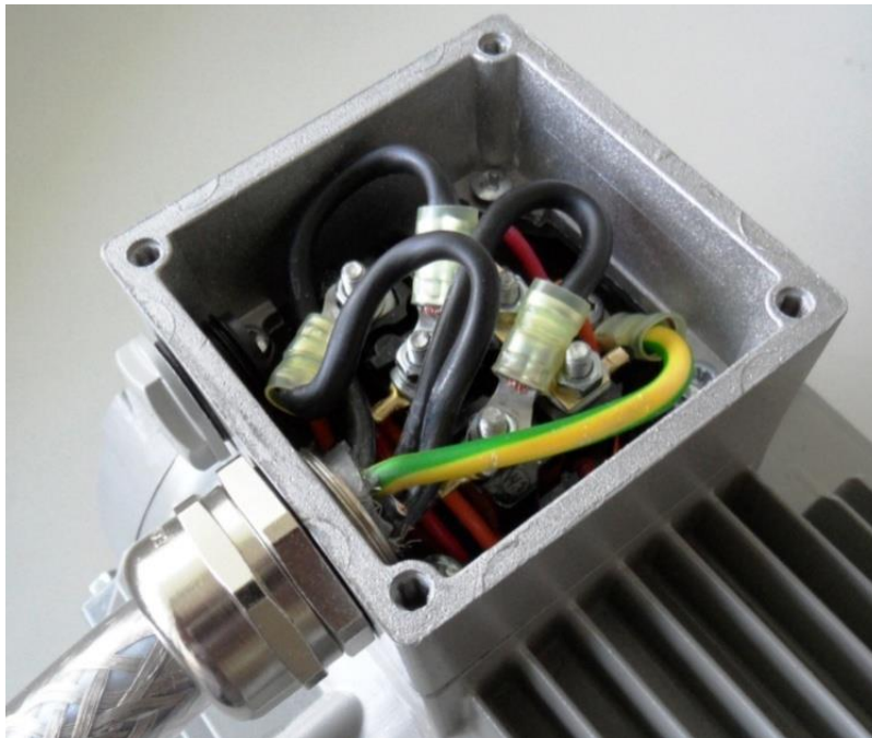
Abb. 20: Verdrahtung am Motoranschlusskasten
