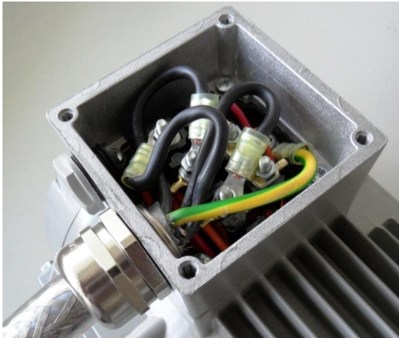
Abb. 16: Verdrahtung am Motoranschlusskasten
